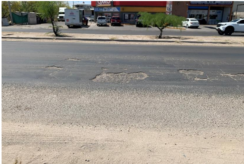
Figura 8.6 Estado del pavimento Carretera, sección noreste
