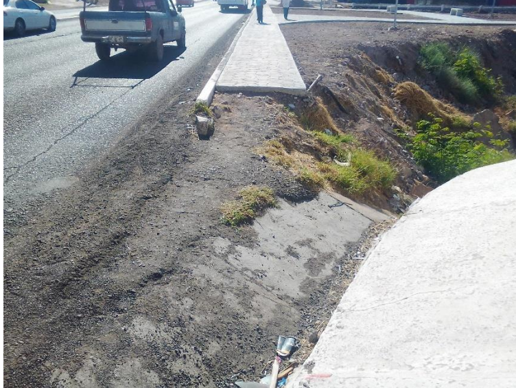
Figura 8.10 Inconexión por arroyo en sección sur poniente
